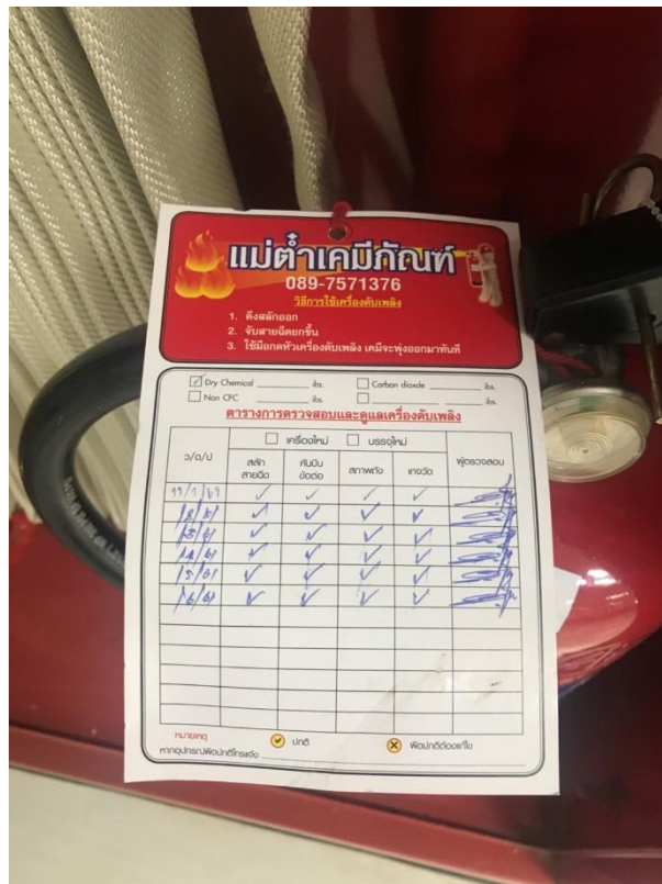
ภาพการตรวจเช็คอุปกรณ์ดับเพลิงประจำเดือน
