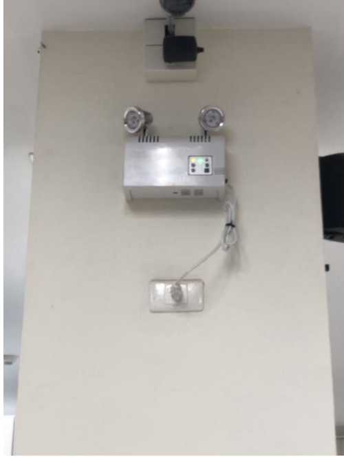
ภาพเครื่องสำรองไฟ
