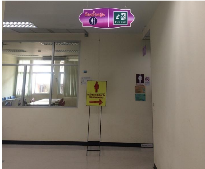
ป้ายทางหนีไฟ
